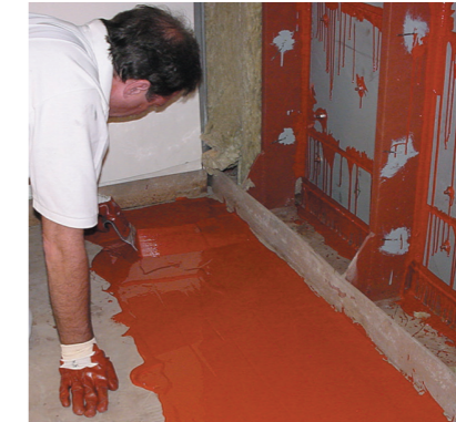
ระบบงานปรับระดับพื้นที่ช่วยลดเสียงและแรงสั่นสะเทือน
